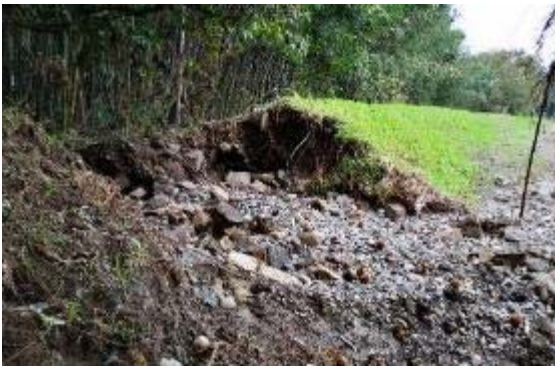
台風で崩れた堤防
