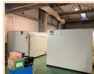
「立川ストックヤード」の設備
