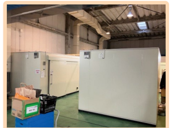
「立川ストックヤード」の設備
