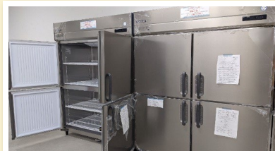
「フードバンクセカンドハーベスト沖縄」で使用している冷蔵・冷凍庫
