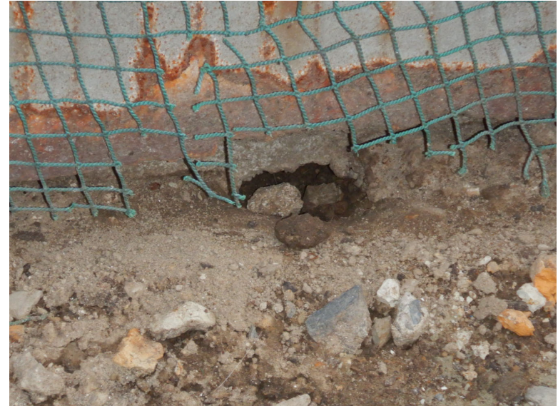
豚舎外壁にねずみが出入りする穴あり。
