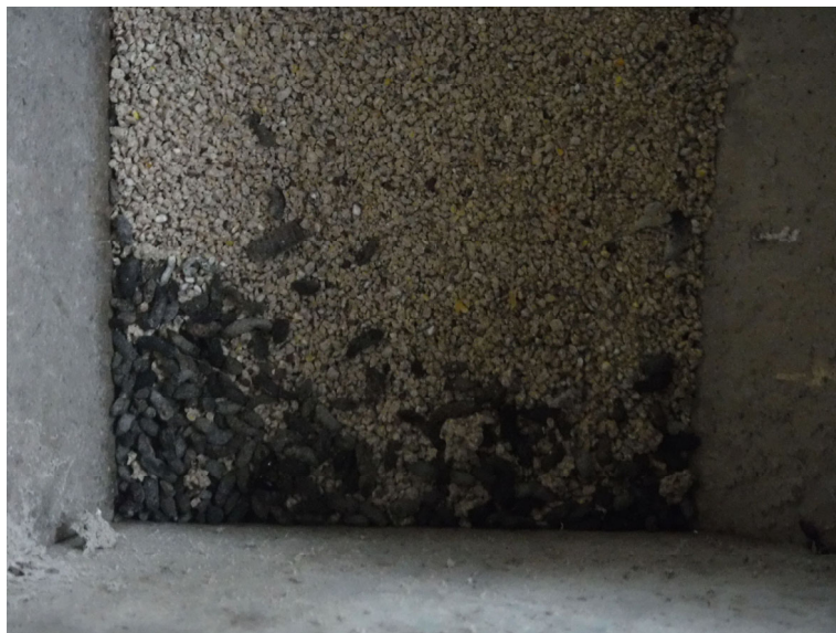
豚舎飼槽内にねずみの糞を確認
