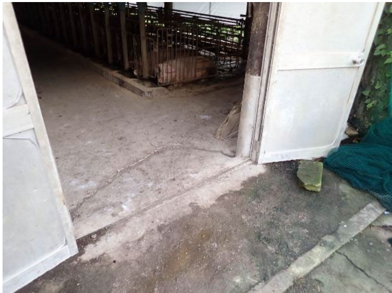
豚舎入口。消毒槽、豚舎専用長靴なし
