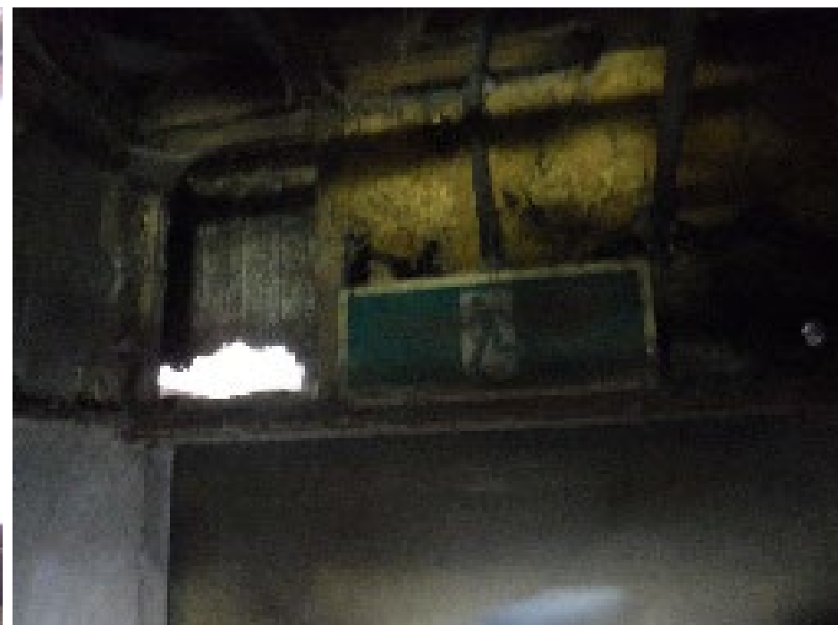
豚舎壁面の破損部
