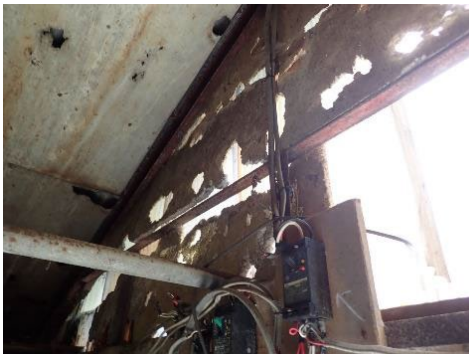
豚舎壁面の破損部
