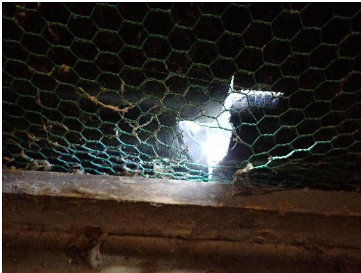
発生鶏舎の破損箇所
