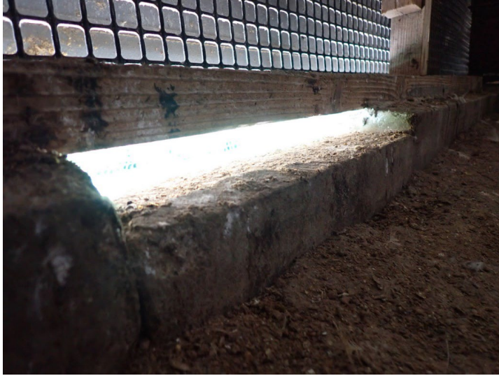
発生鶏舎排水口の閉鎖不全。2cm程度の隙間あり
