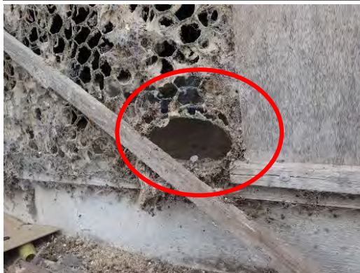
金網や防鳥ネット等の 破損
