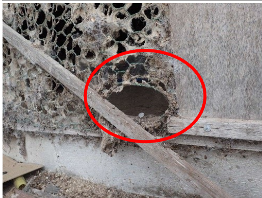
金網や防鳥ネット等の 破損
