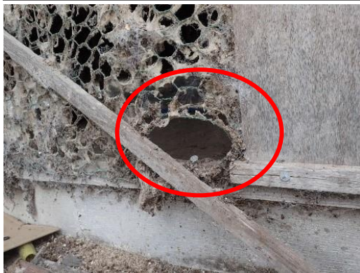
金網や防鳥ネット等の 破損
