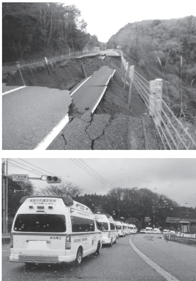
図2 道路崩壊と渋滞の様子
