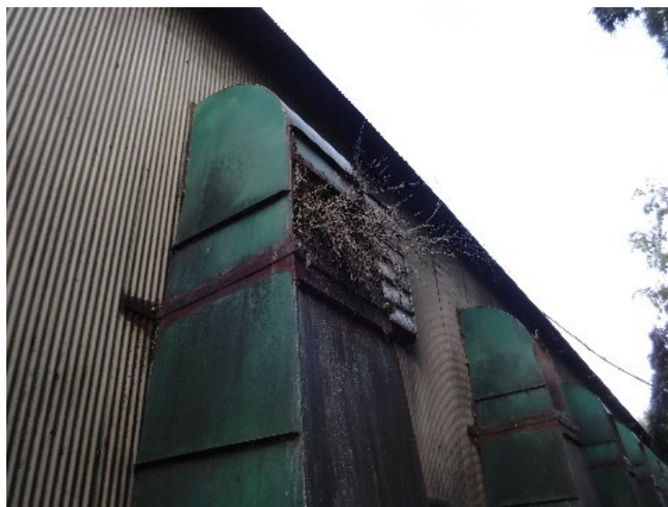
鶏舎排気口ダクトのアライグマとみられる巣 (現在は使用していないと思われる)
