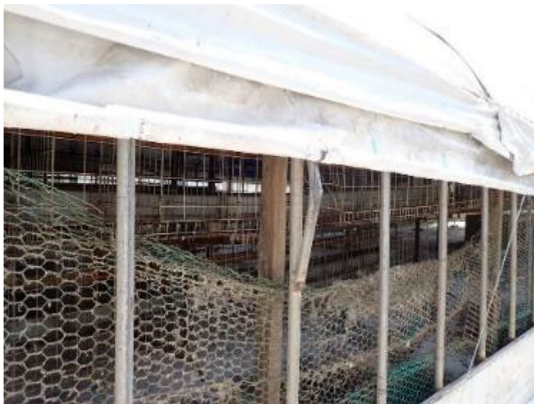
鶏舎壁面の金網の破損
