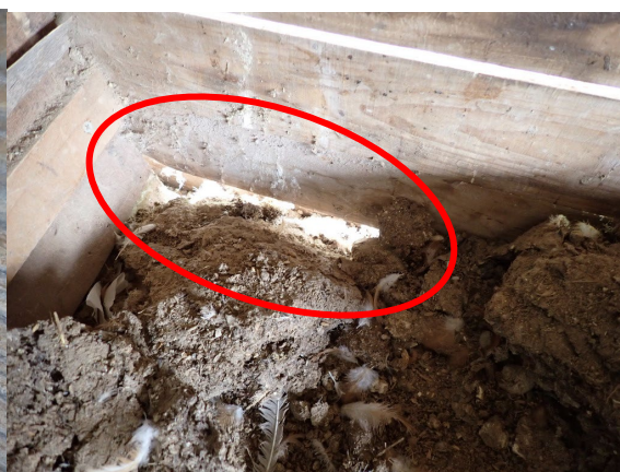
鶏舎壁面の隙間
