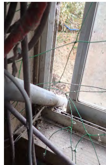
閉鎖できない鶏舎の窓
