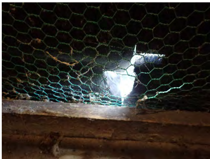
発生鶏舎の破損箇所
