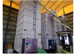
【写真】導入した施設・設備
