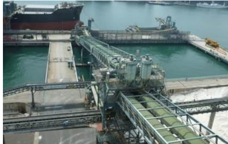
サイロ搬入用コンベア
