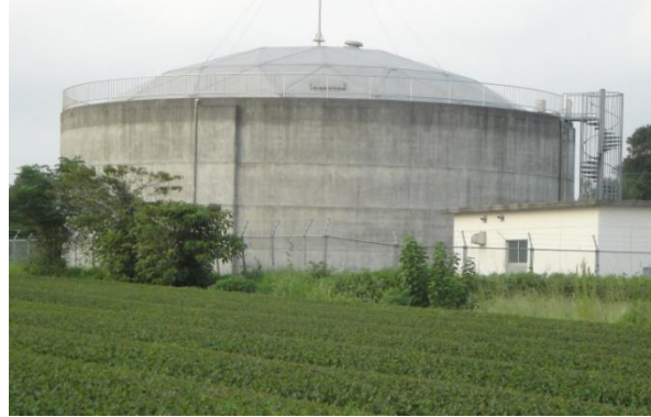
ファームポンド （貯水槽）
