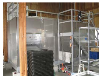
残渣処理設備
