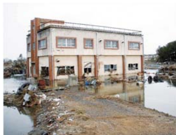
津波により被災した排水機場 (宮城県名取市)
