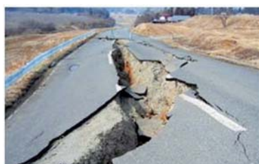
破損した農道(岩手県奥州市)
