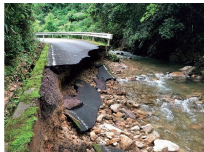
林道施設で路体の崩壊(島根県) (令和3年7月1日からの大雨)
