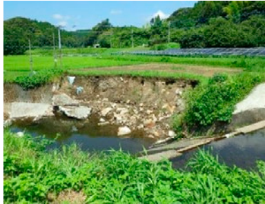
農業用施設の被災状況
