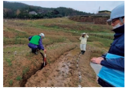
被害状況の調査
