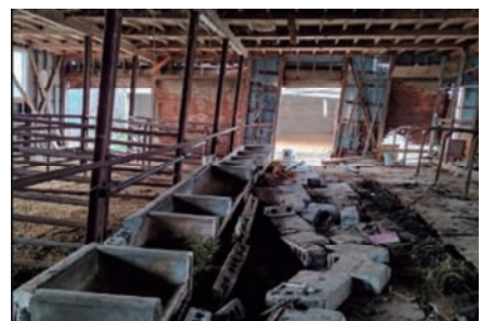
損壊した畜舎
