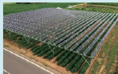
営農型太陽光発電の発電設備
