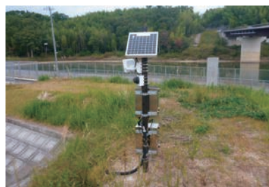
ため池に設置された遠隔監視機器
