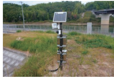
ため池に設置された遠隔監視機器
