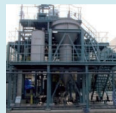
りん回収施設
