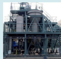
りん回収施設
