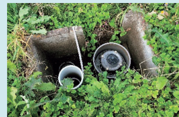
圃場に設置された 地下水位制御システム
