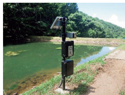
農業用ため池に設置された 遠隔監視機器
