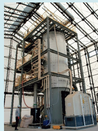
メタン発酵施設
