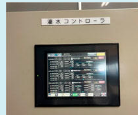
ICTを活用した環境制御装置
