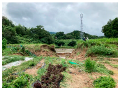
「令和7年8月6日からの大雨」により 決壊したため池堤体(福岡県)
