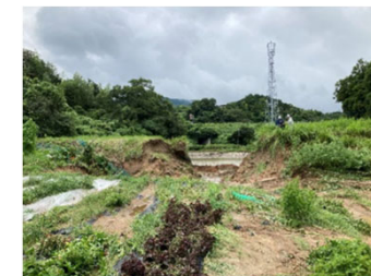
「令和7年8月6日からの大雨」により決壊したため池堤体(福岡県)
