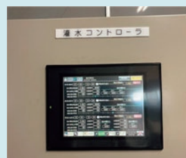
ICTを活用した環境制御装置
