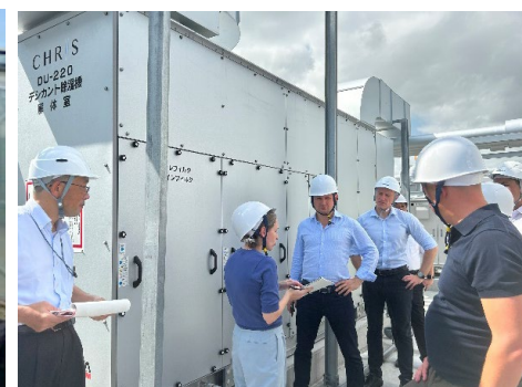
ヒートポンプの視察 (2024.9)
