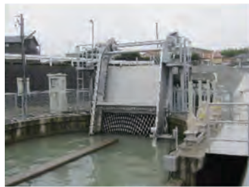
除塵設備（用排水路）
