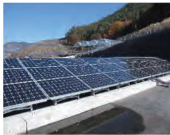
太陽光発電設備
