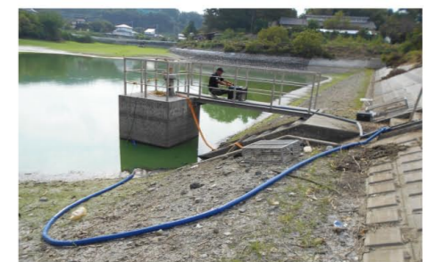
MAFF-SAT支援により設置したポンプ
