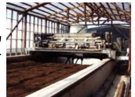
良質な堆肥を供給する堆肥化处理施設等
