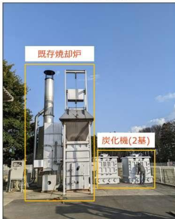
＜炭化機設置場所＞
