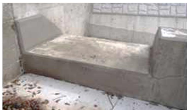
受益面積の減少に合わせて、平時から水位を下げておくためのスリットを設置（長野県長野市浅川池）
