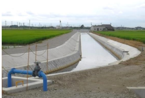
西清水川排水路（栃木南部地区）
