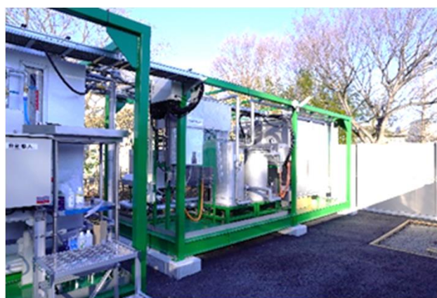
【東京都調布市にある同型設備】
