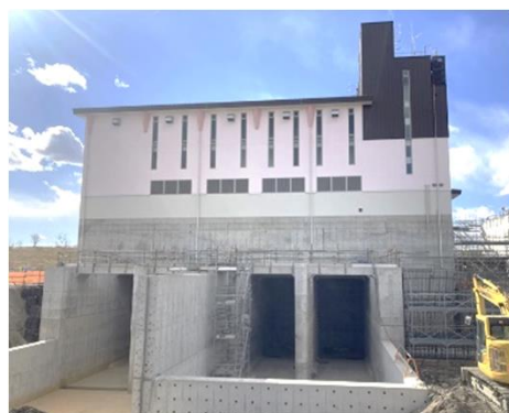
与良川統合排水機場（栃木南部地区）
