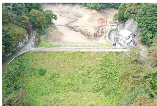
耐震性能が不足している堤体
