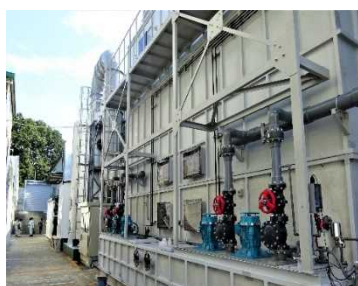
追加された吸着式脱臭装置
