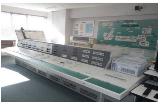
老朽化した水管理システム
