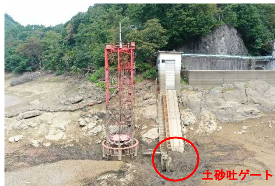
土砂吐ゲートが埋没して機能が低下
