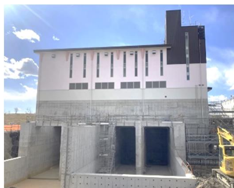
与良川統合排水機場（栃木南部地区）
