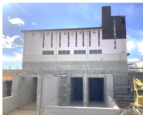
与良川統合排水機場（栃木南部地区）
