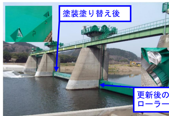
更新したゲート設備
