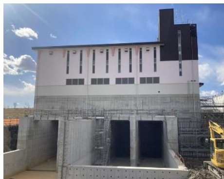
与良川統合排水機場（栃木南部地区）
