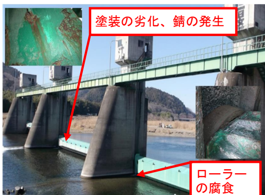
老朽化したゲート設備
