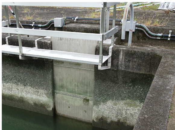
例1) 貯水槽の取水口にフィルターを設置
