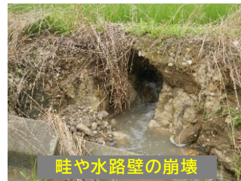
ため池堤体内側の崩落
