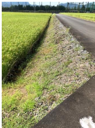
未対策の路肩
