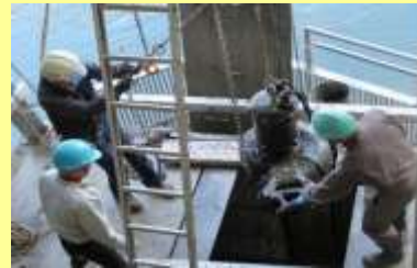
ポンプ設備の機能診断
