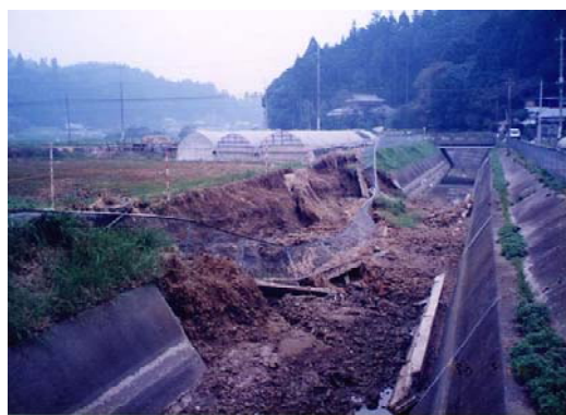
【台風によって崩壊した南部幹線用水路】
