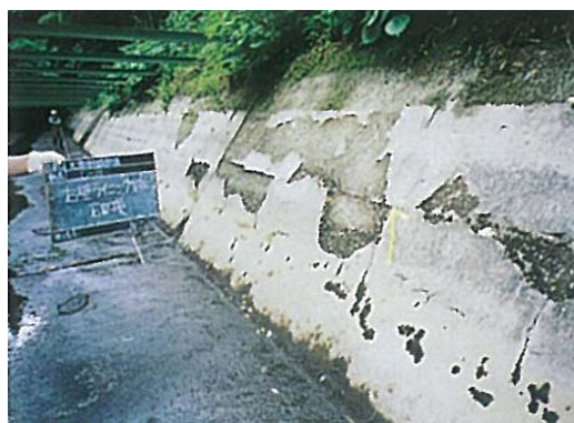
【老朽化した水路断面】
